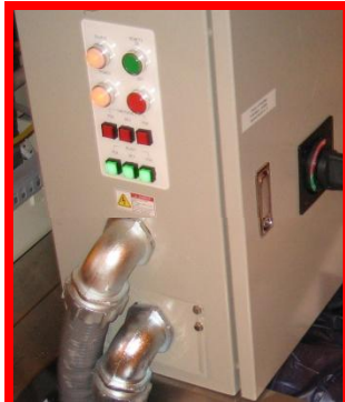
危险电压安装在 接地箱里
